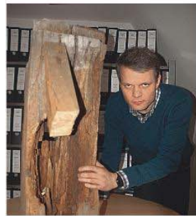
Kirchenkreis-Architekt Johannes Lindner mit einem maroden Dachbalken, der aus der Bergenhusener Kirche stammt. DME
