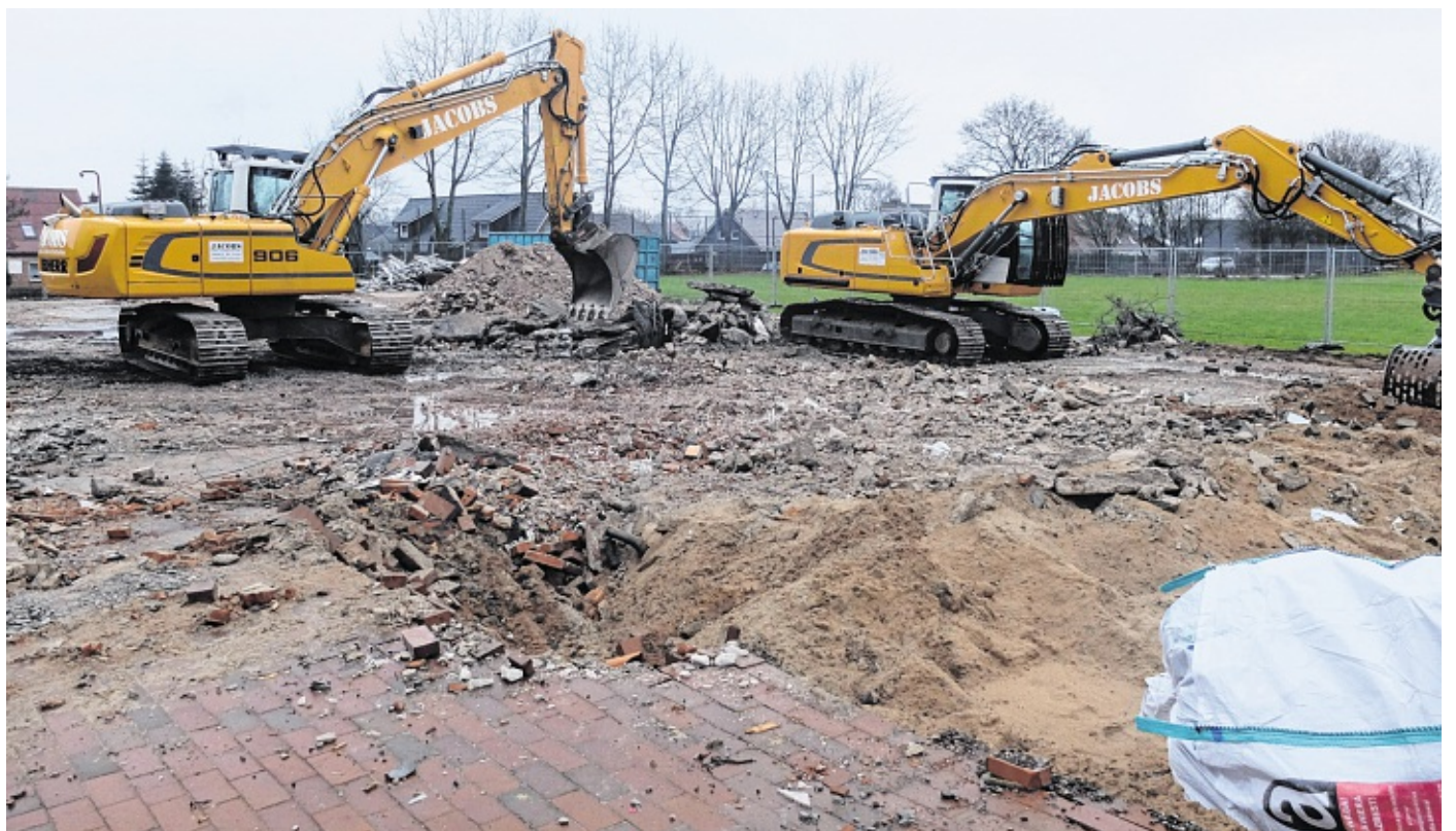
Die Bagger befreien den Platz von den Resten der alten Halle. Bis November soll dort der neue Jugendraum entstehen. THOMSEN
